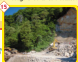
SISTEMAZIONE FRANA REGGIARA E FRANE VARIE (Località Guasime, Lorenzi, Novella, Truffa, Pomari) (tot. 404.620€) Lavori in corso
